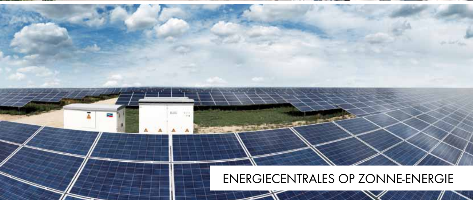
INDUSTRIËLE PV INSTALLATIE
