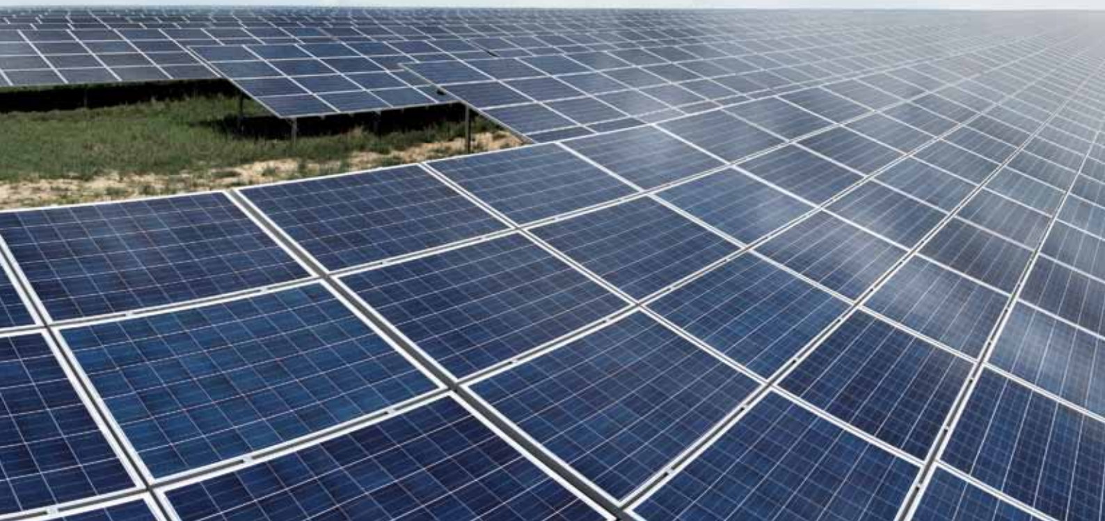
Zonne-energiepark Heideblick, militair vliegveld Gahro, 27,5 MW, gerealiseerd door Enerparc (omvormer: Sunny Central CP)
